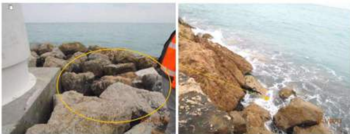
Figure 8 -Glissement des enrochements de la crête de talus en pied du musoir (source : JCECONSEIL 2021)
