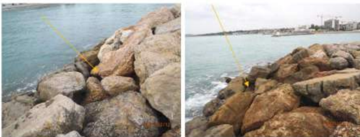
Figure 9 -Glissement des enrochements en crête, affaissement du talus (source : JCECONSEIL 2021)
