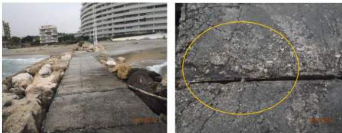
Figure 16 -Dégradations des dalles de protection de la contre-digue du port (source : JCECONSEIL 2021)
