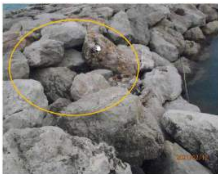
Figure 10 -Glissement des enrochements de la crête (source : JCECONSEIL 2021)
