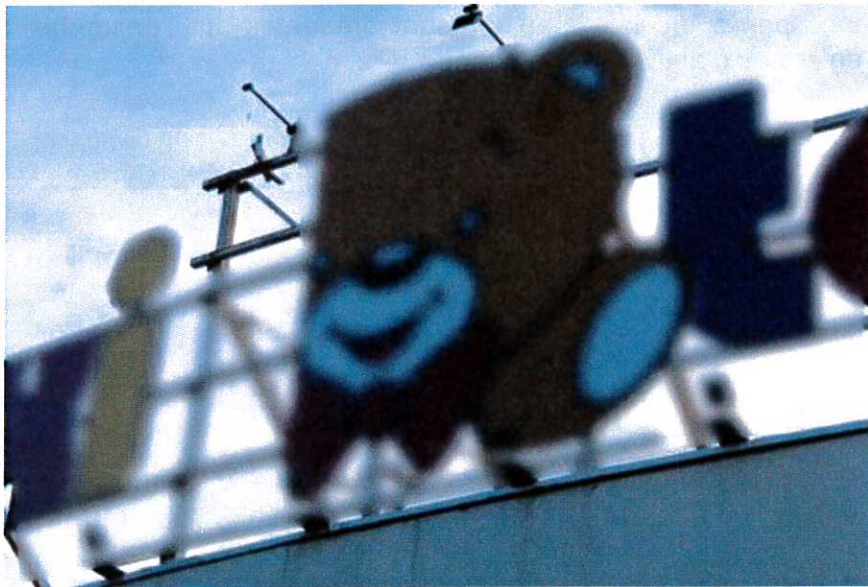
Enseigne sur toiture ou terrasse en tenant lieu en mauvais état d'entretien, Villeneuve-Loubet, Juin 208.
