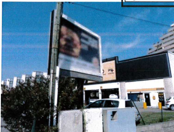
Publicité scellée au sol ou installée directement sur le sol en mauvais état d'entretien, Villeneuve-Loubet, juin 2018.
